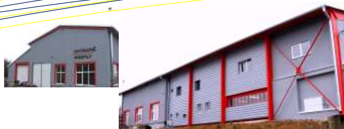
Zateplení objektu fa. Ohýbané profily a.s. Rojetín Výměra: 750m 2 , Systém: Ceretherm Premium + PUR panely Cena: 1.050.000,00Kč Investor: Ohýbané profily a.s., Provedení včetně oplechování.
